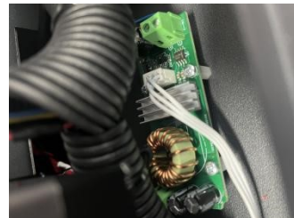
Panel de control de calefacción
