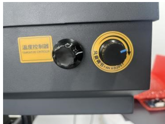
Control de calefacción y ventilador
